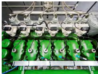
Heute Biogas, Biomethan, Erdgas, H2....
